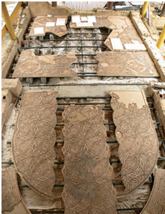
Figure 7 Assemblage des panneaux constitutifs des mosaïques n°s 7 et 8 lors de leur repose in situ en 2014. © ARM (Atelier de restauration de mosaïques de Saint-Romain-en-Gal)
