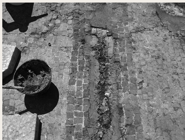
Figure 3 Comblement des lacunes dans une des bordures et pose de solin dans une lacune. Photo: M. C. Hamza
