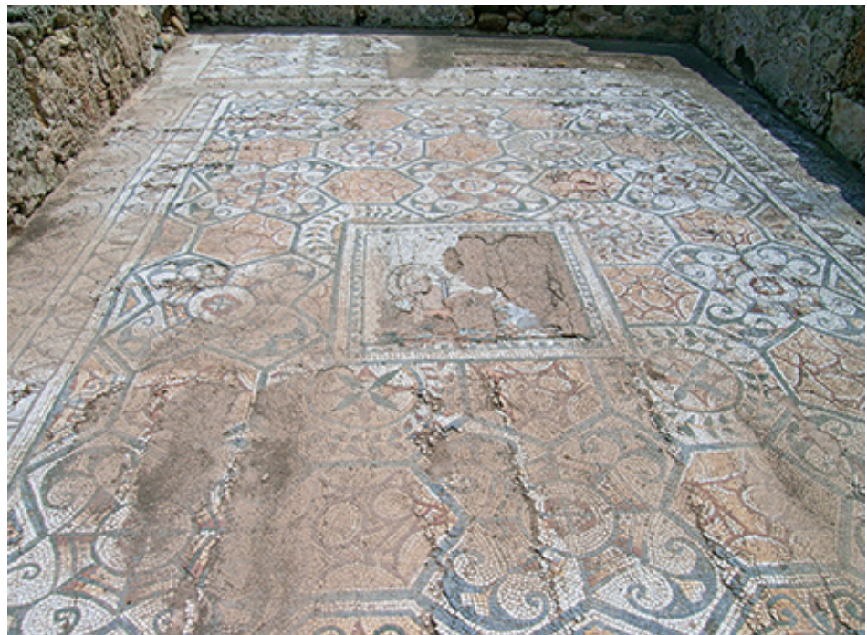
Figura 3 Casa dell'Atrio Tetrastilo, vano D: deformazione del tessellato, presenza di lesioni, deformazioni (il copyright è detenuto dagli autori e le immagini sono degli autori)
