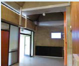
recenter leiding-werk storend aanwezig
