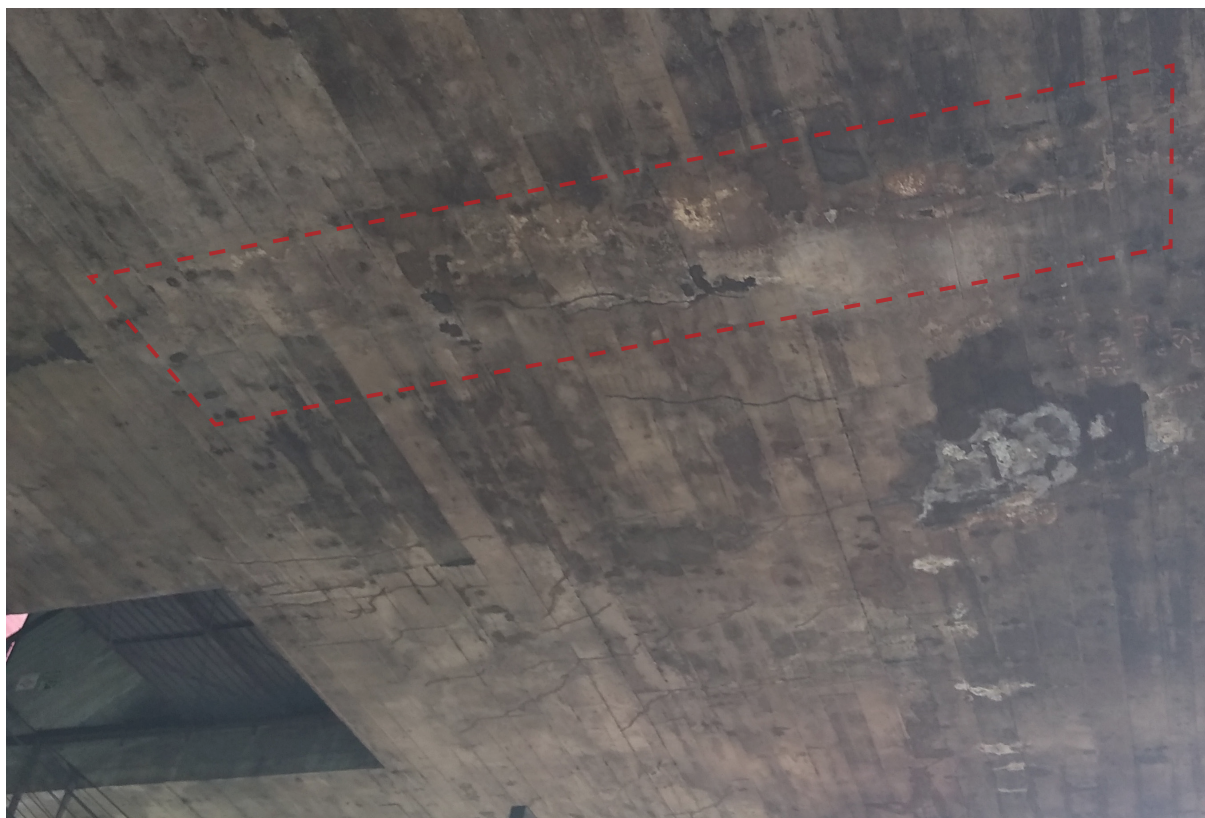
[82] Em destaque: fissuras da viga V16p
