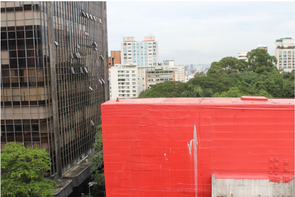
[74] [75] [76] Patologias na Laje do primeiro pavimento (teto do Vão Livre) e na viga de cobertura
