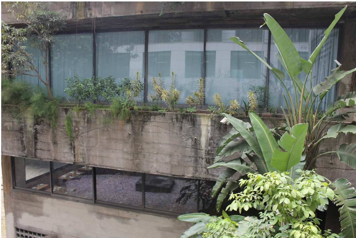
[77] [78] [79] [80] Patologias nas fachadas do volume inferior
