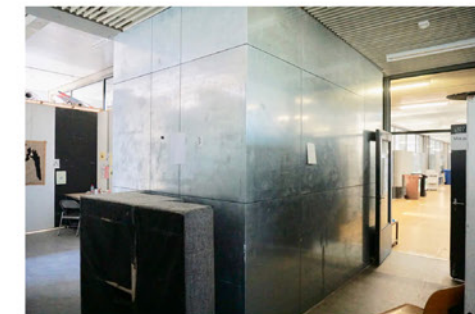
metalen doos tbv nieuwe luchtbehan- delingsinstallatie (sinds 2003)
