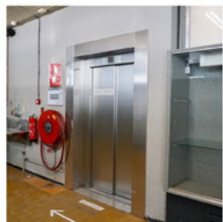
liften recent vervallen; nieuwe deuren en kozijn sto- rend aanwezig
