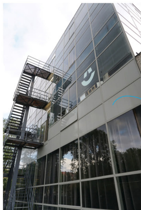
de pui is plaatselijk geblinddeerd
