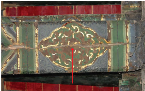
梁上画层的水平裂纹。
