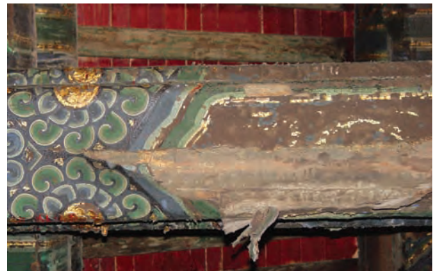
水平裂缝造成彩画完全脱落。
