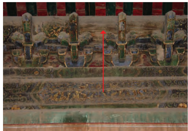
檐檩上的彩画缺失（明间南墙）。
