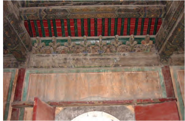
室内墙壁上雨水渗透的痕迹。
