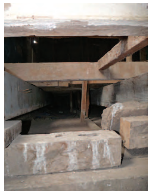
FIGURAS 3.39 Y 3.40 (ARRIBA Y ABAJO) Cala IIS-1 que muestra los traslapes de las vigas, probablemente debido a la eliminación de un muro en el Bar Cordano, en el nivel inferior. Imagen: Mirna Soto, para el GCI.
