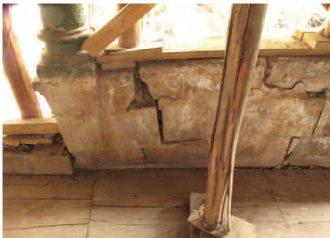
FIGURA 6.46 Vista del extremo oeste del parapeto de mampostería de piedra de la arquería sur, desde la habitación B-206. Imagen: Sara Lardinois.
