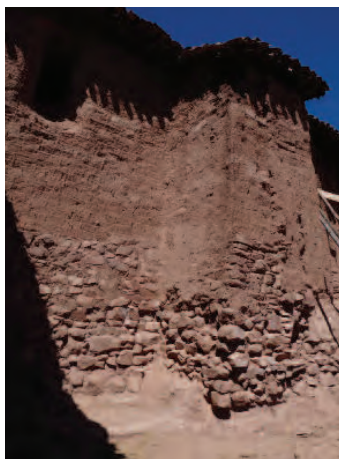
FIGURA 5.12 Detalle de erosión en el muro de la Epístola. Imagen: Mirna Soto, para el GCI.
