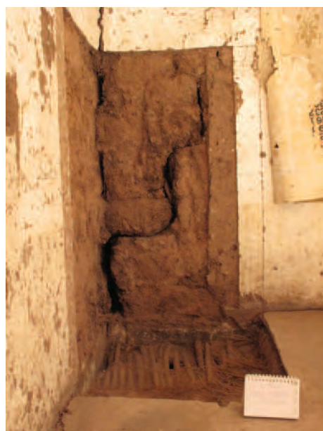
FIGURA 6.43 (IZQUIERDA) Grieta en el muro de adobe en el segundo piso de la esquina suroeste de la edificación, lo que indica una desconexión entre la fachada de la calle Arones (este) y el muro perimetral sur. Imagen: Claudia Cancino.
