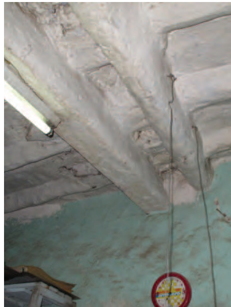
FIGURA 6.31 (IZQUIERDA) Vista del cielo raso de la habitación C-10. Puede observarse la viga madre en dirección este-oeste y las viguetas que soporta. Imagen: Sara Lardinois.
