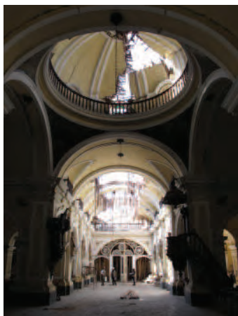
FIGURA 4.3 Vista de los daños en la cúpula y bóveda después del terremoto del año 2007.
