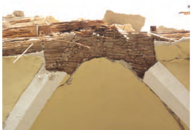
FIGURA 4.51 (ARRIBA) Sector C: Daño en las cerchas que forman la bóveda, mostrando corrosión de los clavos que conectan los camones. Imagen: Claudia Cancino.
