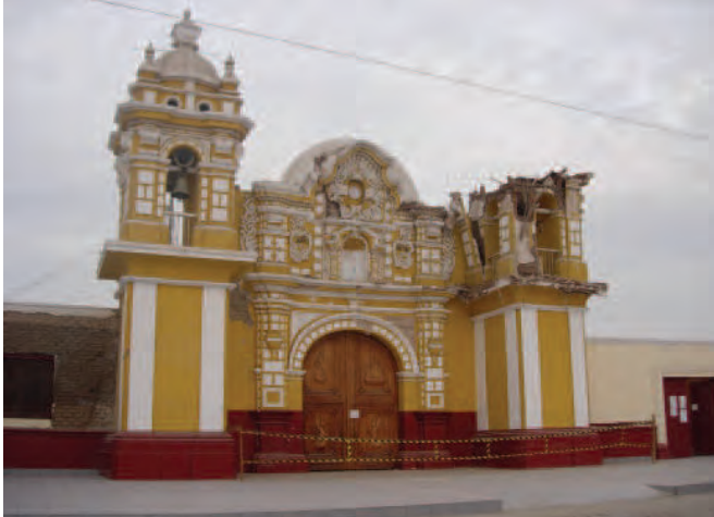
FIGURA 1.3 Iglesia de El Carmen, Chincha, Perú. Edificación construida de tierra cuyo campanario colapsó durante el terremoto de Pisco de 2007. Imagen: Philippe Garnier, para el GCI.
