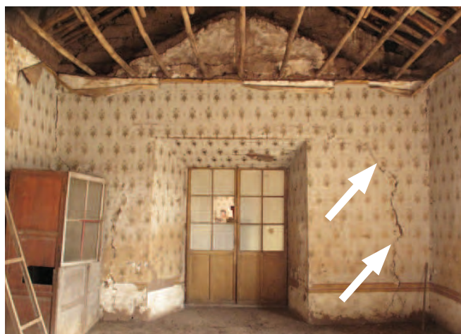
FIGURA 6.42 Grieta vertical en la partición entre las habitaciones A-203 y A-204, que dan a la fachada este hacia la calle Arones. Imagen: Claudia Cancino.
