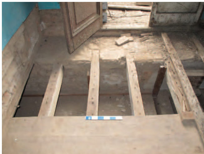
FIGURA 3.37 (ARRIBA) Cala IIS-1 (habitación 243) que muestra el sistema constructivo del entrespacio del segundo nivel sobre el Bar Cordano. Dibujo: Mirna Soto, para el GCI.
